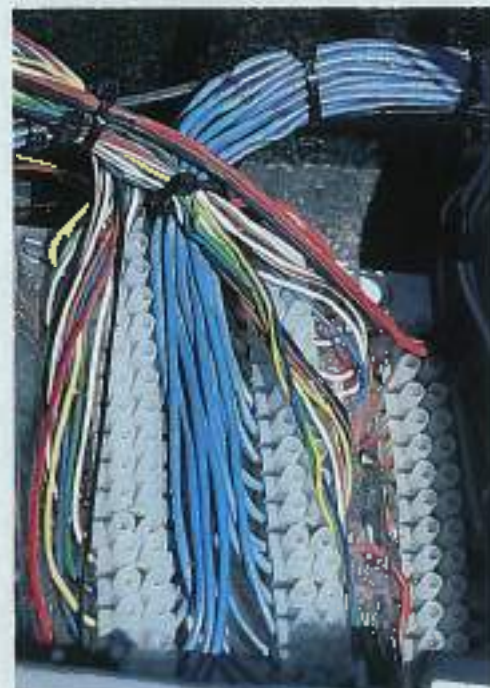
Detalle del panel de reglas para el conec-tionado general.
